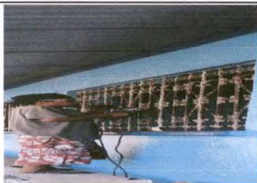
Foto 15: Mantenimiento a balcones de metal por deterioro en pintura, aula 2, total de metros 12, son dos lados de 6 metros cada uno
