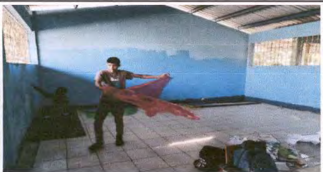
Foto 21: Pintura de aula 3 se pintará debido al tiempo y falta de pintura en algunos segmentos de la pared. Total de metros 98.33 m².
