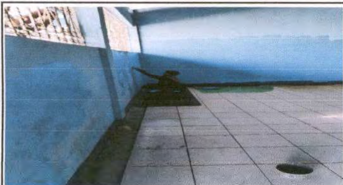
Foto 13: Pintura de aula 1, se pintará debido al tiempo y falta de pintura en algunos segmentos de la pared. Total de metros 98.33 m²
