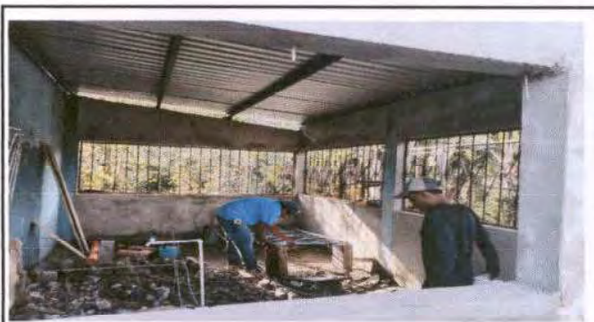
Foto 4: Este espacio corresponde a la cocina escolar, ha generado problemas con el humo cuando se cocina, por falta de ventilación, necesitamos instalar balcones a la altura de la celosía haciendo un total de 10 m². (10mx1m)
