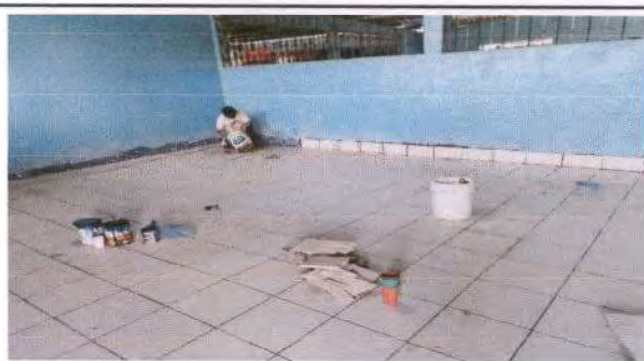
Foto 16: En aula 2, se colocará piso cerámico debido al deterioro del piso liso. Total de metros 51.5 m².
